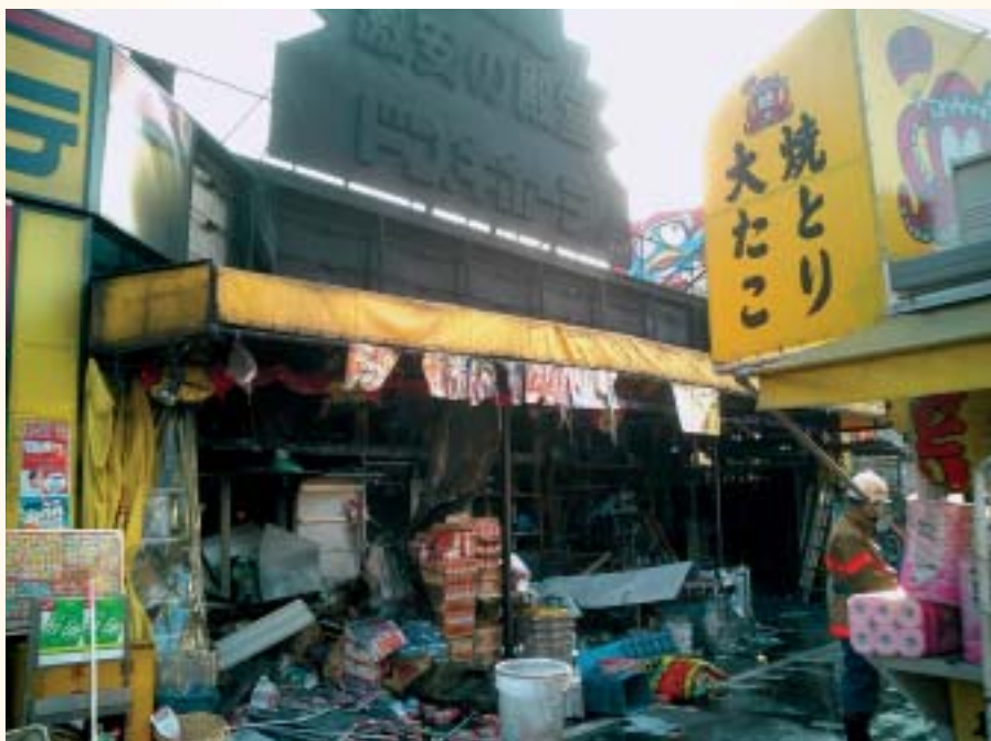
火災発生後のドン・キホーテ浦和花月店の外観
