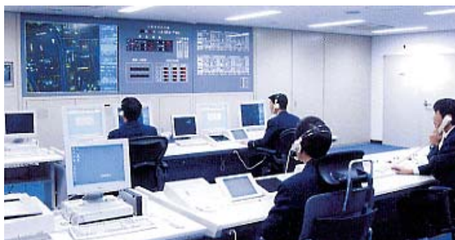
新消防通信指令システム
